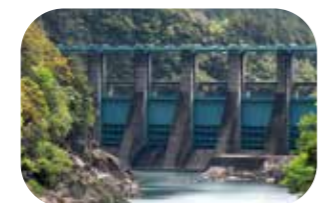
ダムゲート稼働監視
